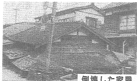
倒壊した家屋
